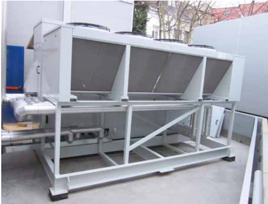
Lidl | Elsene 20130923 08: De warmte die vrijkomt uit de koelinstallatie wordt in de vloer gestopt door middel van betonkernactivering.
